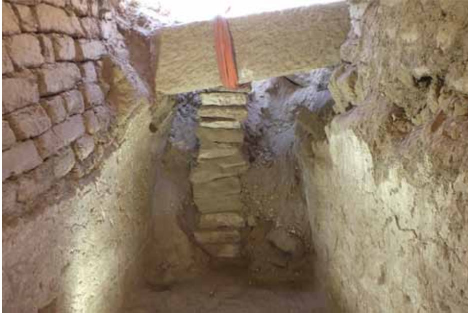
A.- Ramesseum. Secteur STI (STI.TR/SA06). Soutènement mis en place par l'équipe anglaise de J. Quibell (1896), sous une dalle de plafond ramesside effondrée sur la toiture voûtée de la tombe de Sehetepibrê (Moyen Empire, XII e dynastie). [Cliché © Christian Leblanc].
