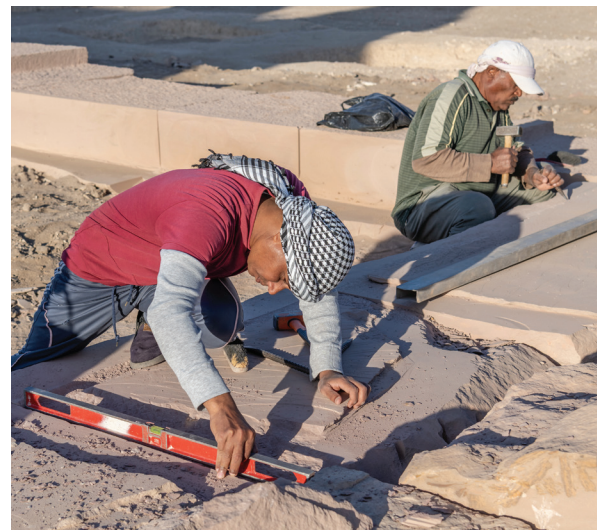
Tailleurs de pierre à l'œuvre sur l'un des murs de la troisième petite salle hypostyle du temple. Cliché Joël Boissin.
